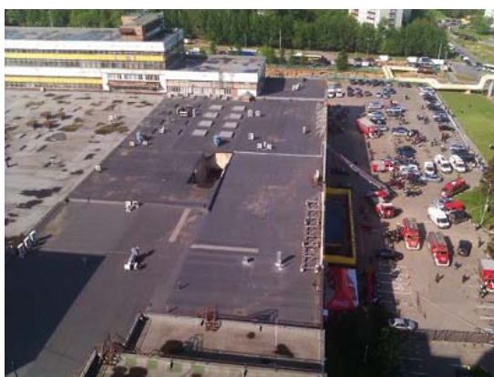
Рисунок 1. – Причина частичного обрушения перекрытий крыши в торговом здании – нарушение норм его эксплуатации
